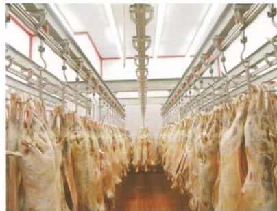
• Ψυκτικός θάλαμος σφάγιων με σιδηροτροχιές τύπου Bi-RAIL και αναρτημένα σφάγια αρνιών
